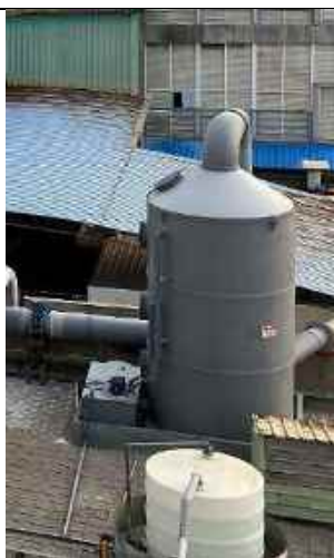
7#厂房布袋除尘器+水喷淋塔（序号12）
