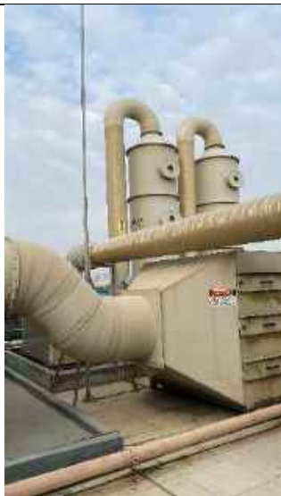
实验室尾气两级碱液喷淋塔（序号 5）
