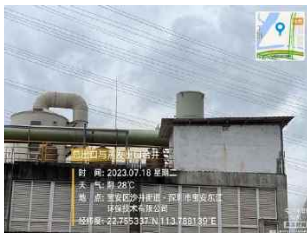
含铜废蚀刻液暂存及预处理车间、7#厂房 总排放口（G2）
