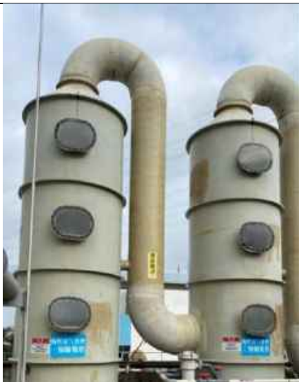
6#厂房压滤机酸性尾气 两级碱液喷淋塔（序号1）
