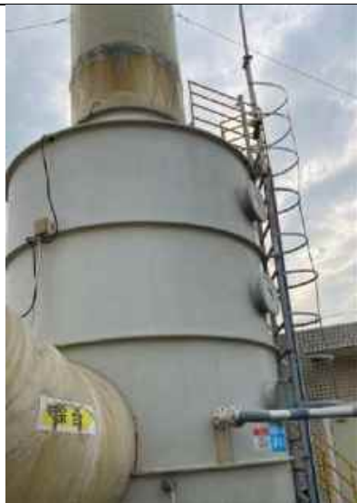
综合水喷淋塔（序号 7）
