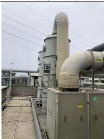
含铜废蚀刻液暂存及预处理车间 四级碱液喷淋塔（序号 8）
