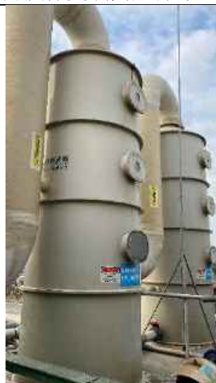
6#厂房反应罐碱性尾气 两级酸液喷淋塔（序号4）
