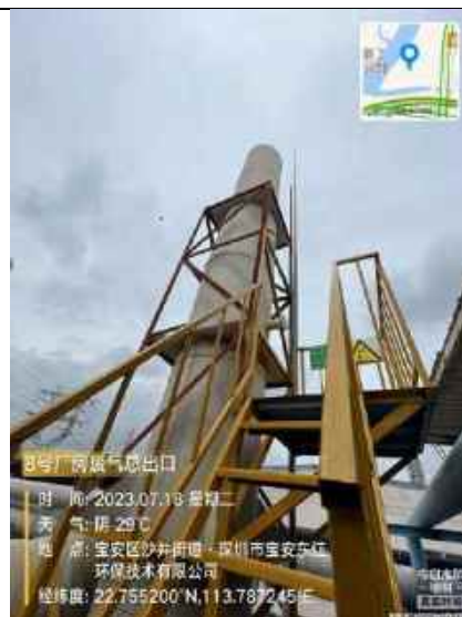
8#厂房 两级碱液喷淋+活性炭吸附装置 G4排放口（序号14）
