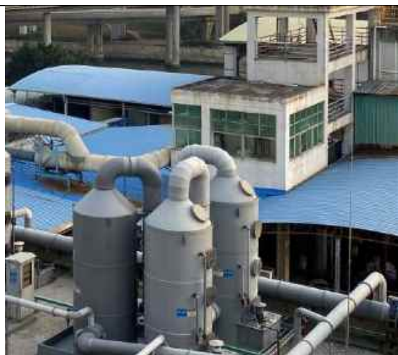
7#厂房两级碱液喷淋塔（序号10）
