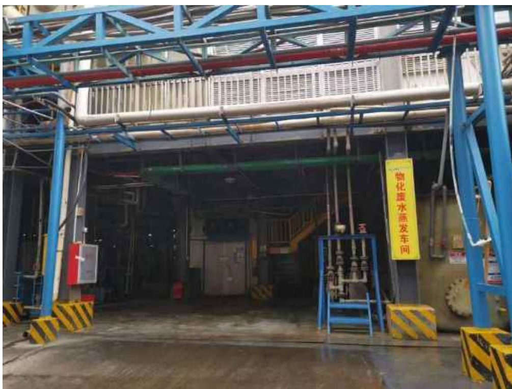
处理“高盐废水+有机废水”的 MVR 蒸发器与三效蒸发器
