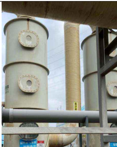
6#厂房压滤机碱性尾气 两级酸液喷淋塔（序号2）
