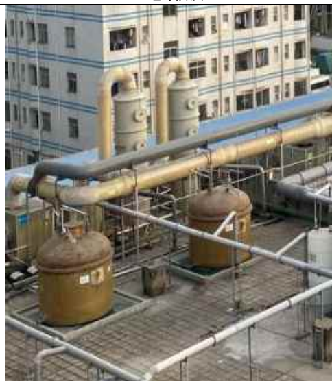
含铜废蚀刻液暂存及预处理车间 两级酸液喷淋塔（序号 9）
