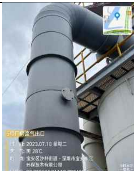
5#厂房 两级碱液喷淋+活性炭吸附装置 G3排放口（序号13）
