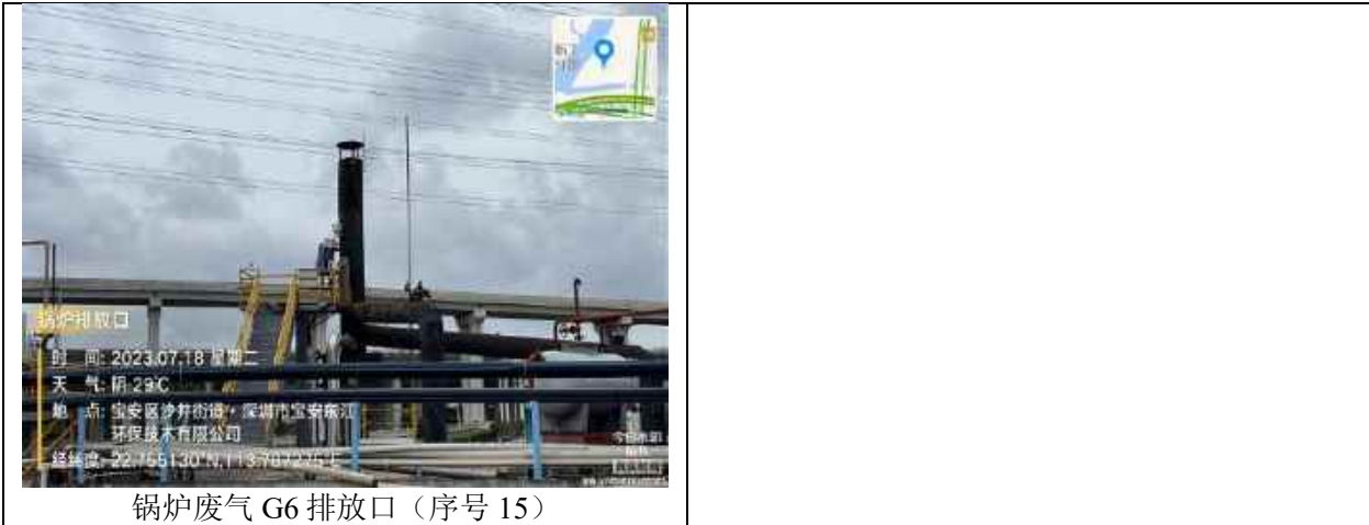
图 4.3-3 项目废气处理设施现场照片
