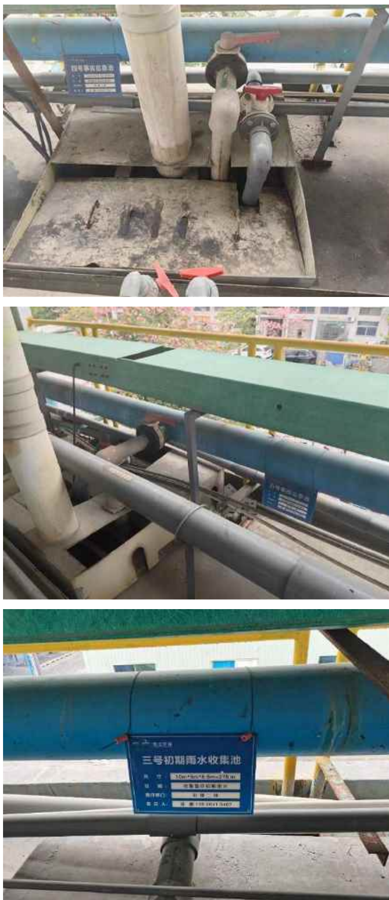
图 4.2-5 新增事故应急池与初期雨水收集池现场照片
