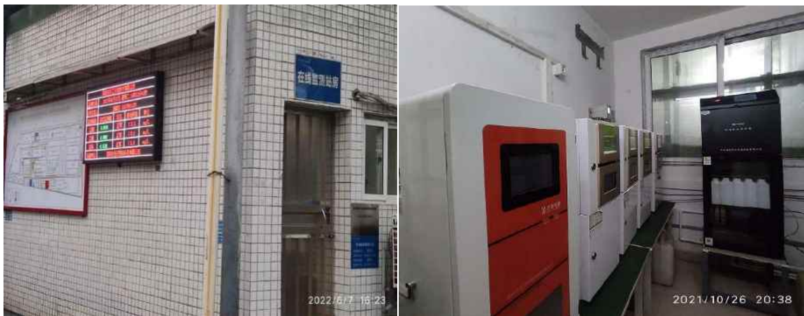
图 4.3-2 废水在线监测站房
