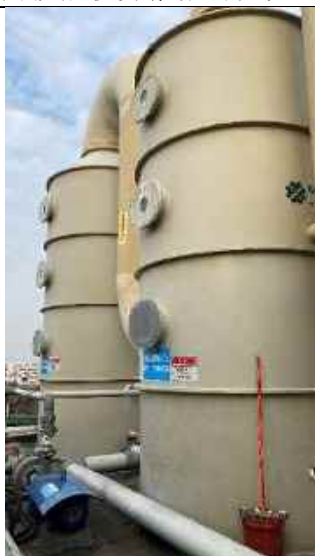
6#厂房反应罐酸性尾气 两级碱液喷淋塔（序号3）
