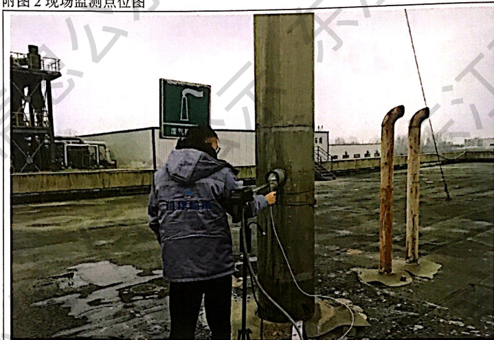
◎1#锅炉废气排气筒 (DA009)
