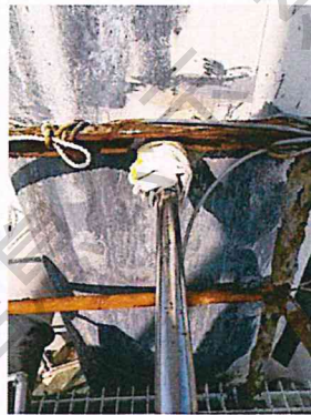
DA004 废气排放口 5 处理后
