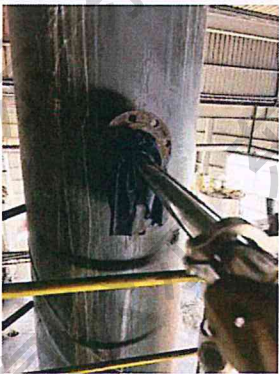
DA006 锅炉废气排放口处理后
