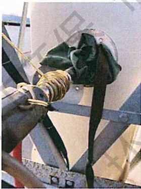
DA002 废气排放口 2 处理后
