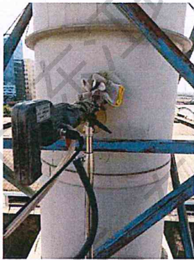
DA001 废气排放口 4 处理后
