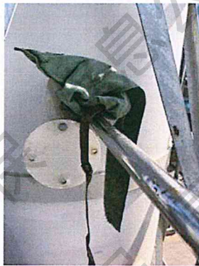
DA003 废气排放口 1 处理后
