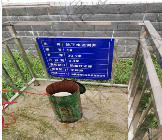
地下水检测井☆5
