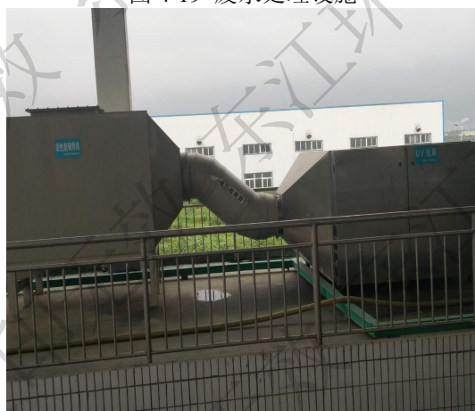
图 4-21 废水处理尾气活性炭吸附
