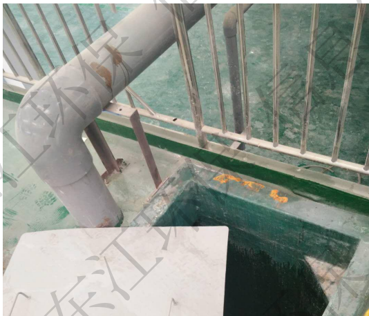
含铜污泥车间排口★4
