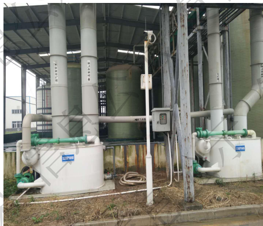
图 4-23 罐区文丘里尾气吸收器
