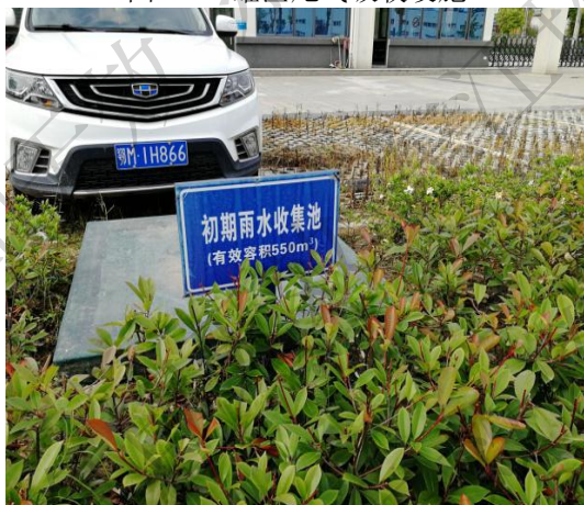
图 4-24 初期雨水收集池
