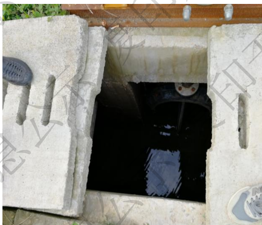
图 4-8 初期雨水切换阀
