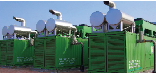
深圳下坪填埋气发电厂 年发电量约6000万度，可供6万户居民全年使用 SHENZHEN XIAPING LANDFILL GAS POWER PLANT Annual output 60 million KWH, supply for 60,000 household.
