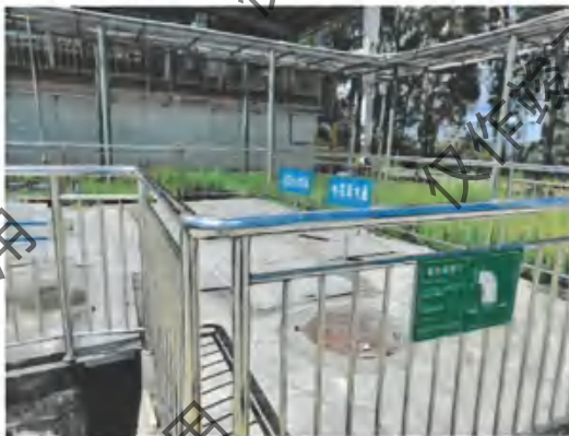
图 4.2.1-3 雨水阀门和雨水排放口
