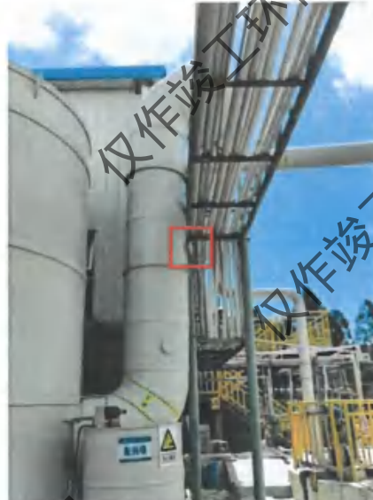
图 4.2.2-4 污泥减量化车间废气处理设施进口采样口
