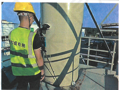
预处理废气排放口 DA002
