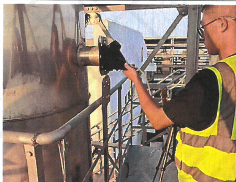
甲类仓库废气排放口 DA001
